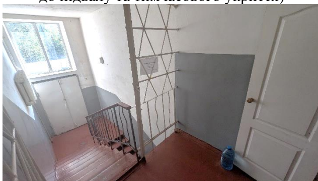
Фото 23 - Характерний вигляд внутрішніх вертикальних шляхів руху (пожежний вихід з блоку душових)
