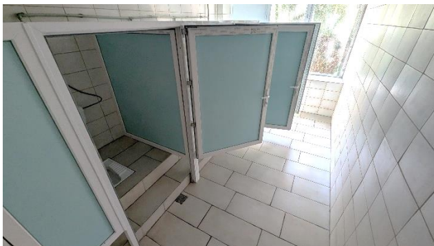
Фото 47 - Характерний вигляд санітарно-гігієнічних приміщень
