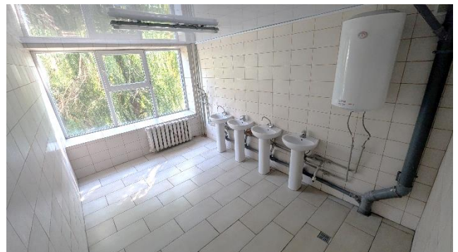
Фото 48 - Характерний вигляд санітарно-гігієнічних приміщень
