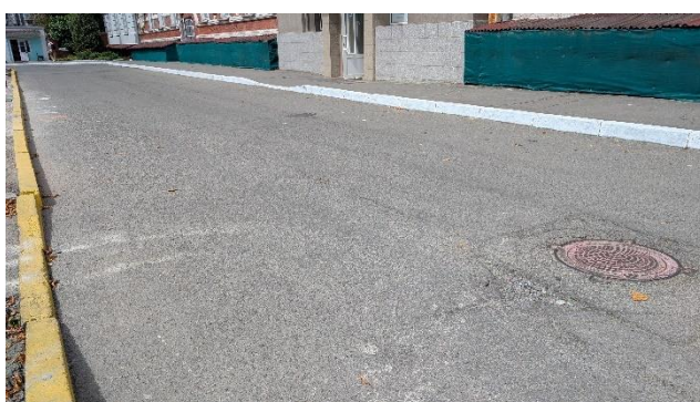
Фото 13 - Пониження бордюрного каменю по зовнішнім шляхам руху
