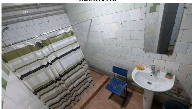
Фото 15 - Характерний вигляд санітарно-гігієнічних приміщень
