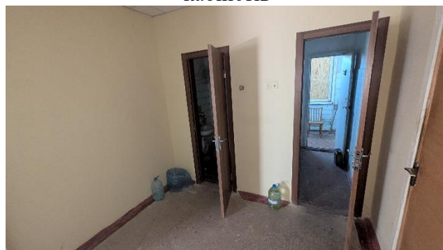
Фото 14 - Характерний вигляд санітарно-гігієнічних приміщень
